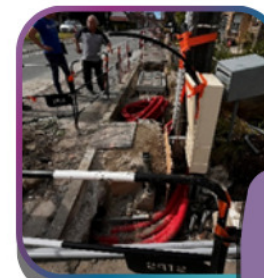
Bergues Mise en service de 2 bornes IRVE 23 mai 2024
