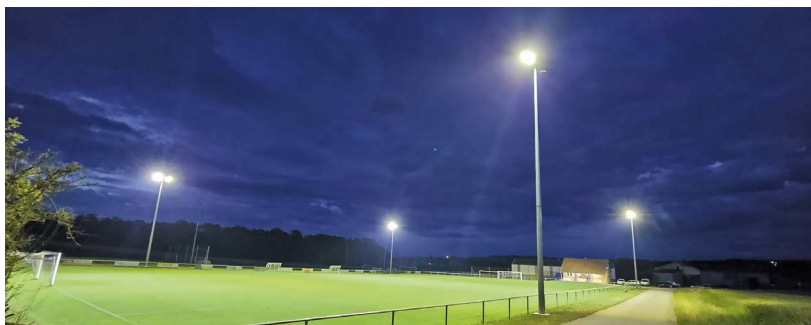
Éclairage stade FC SCHAFFHOUSE
