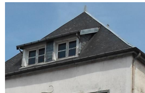
Exemple de lucarne rampante interdite.
