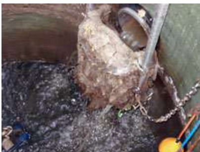
Lingettes obstruant une grille du réseau
