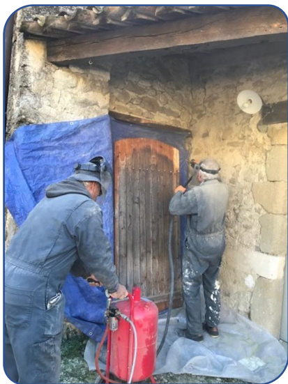
Gommage des portes
