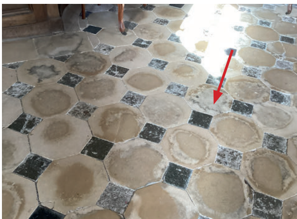
59. Dallage présentant des signes d'usures avancés liées au défaut d'hygiène sanitaire: remontées d'humidité.
