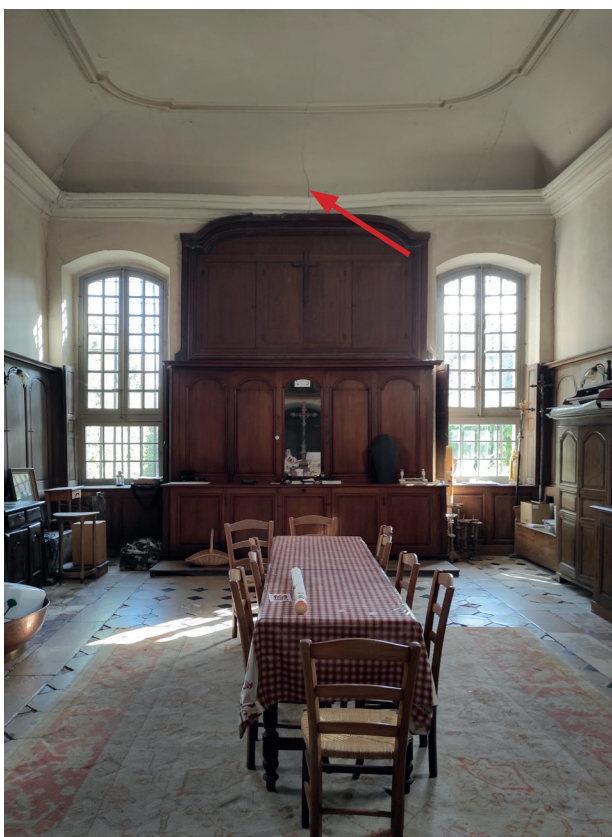
57. Fissure des enduits de la sacristie, avec encrassement en cueillie.
