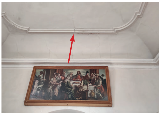
58. Fissure des enduits de la sacristie.
