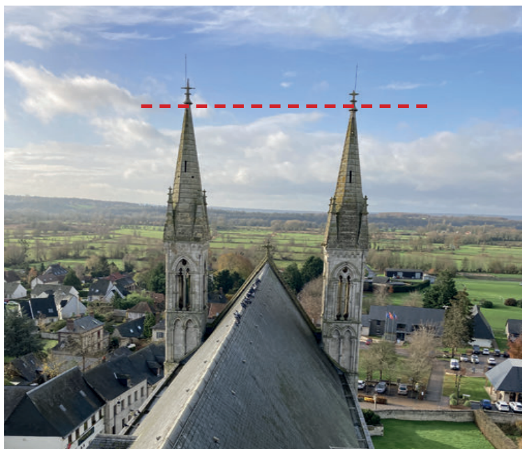
2. Pour un ouvrage symétrique, léger tassement relevé de la tourelle Nord-ouest.
