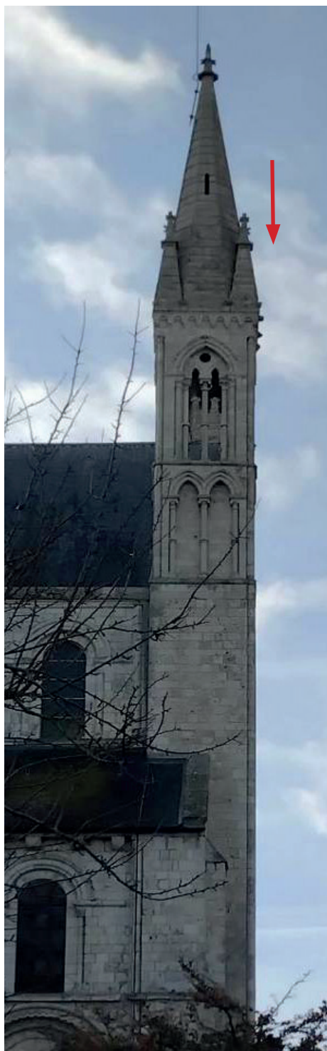
1. Tassement constaté de la tourelle Nord-ouest.
