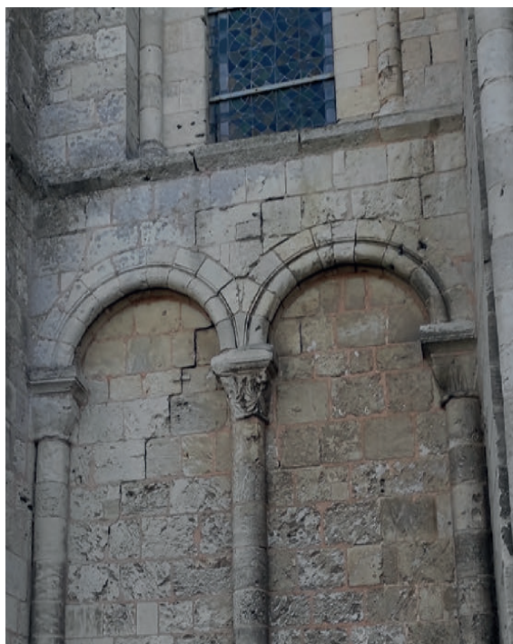
7. Fissure en escalier suivant l'appareillage au droit de l'arcade aveugle du massif occidental.
