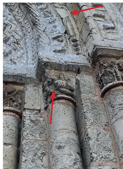
11. Chute d'éléments décoratifs du portail occidental et encrassement à l'abri, en intrados d'arcades des chapiteaux: vieillissement et dégradation des pierres.
