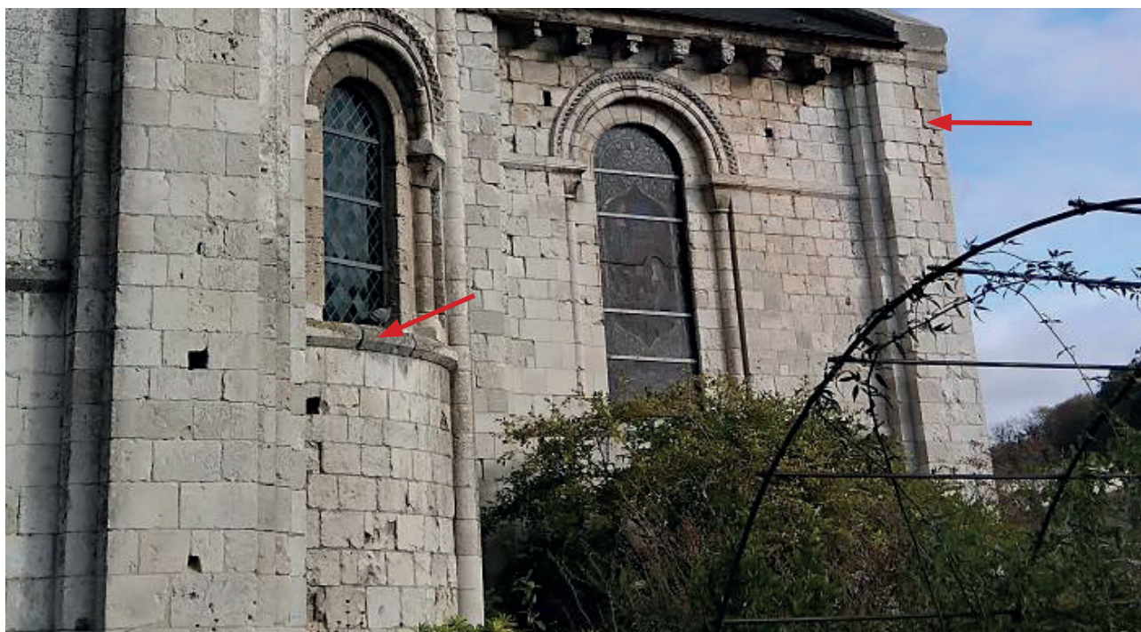
17. Fissuration de la maçonnerie extérieure du contrefort de l'extrémité du bas-côté Sud du chevet et en partie inférieure de la chapelle orientée du transept.
