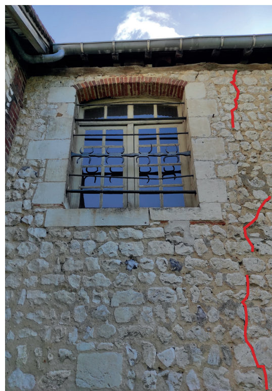
10. Sacristie, fissures au droit de l'élévation.
