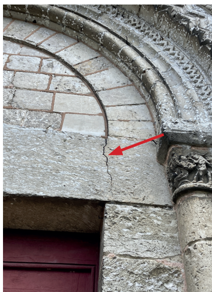
9. Fissure au droit du sommier du linteau soutenant le tympan du portail occidental.
