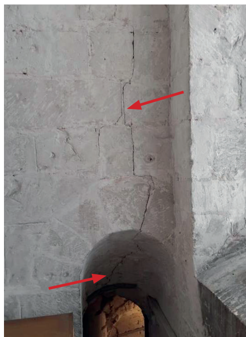
22. Fissure verticale se prolongeant vers l'ouverture menant à la tourelle d'escalier.
