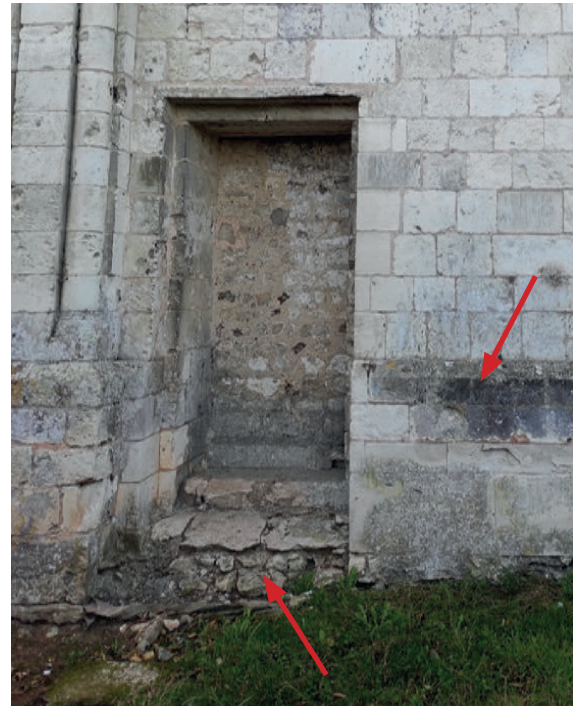
2. Embranchement fortement altéré, première marche devenue inexistante, encrassement généralisé. (ouverture condamnée).
