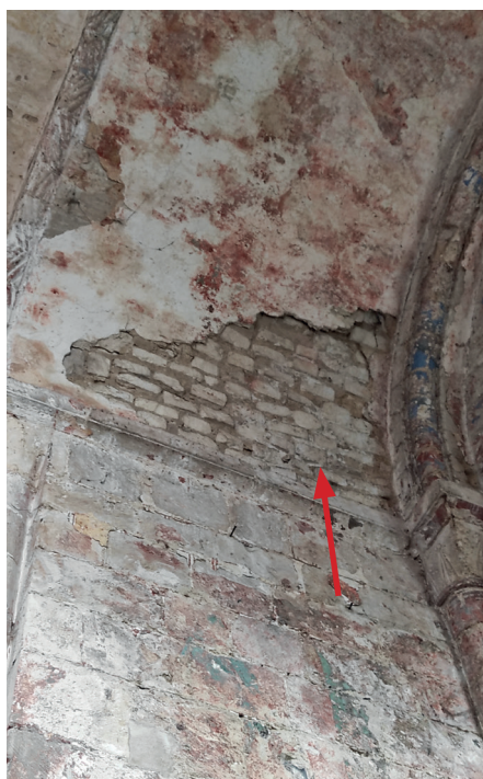
34. Décollement et chute des enduits, mise à nu de la maçonnerie.
