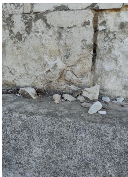
15. Chute constatée de matière au droit de l'élévation.
