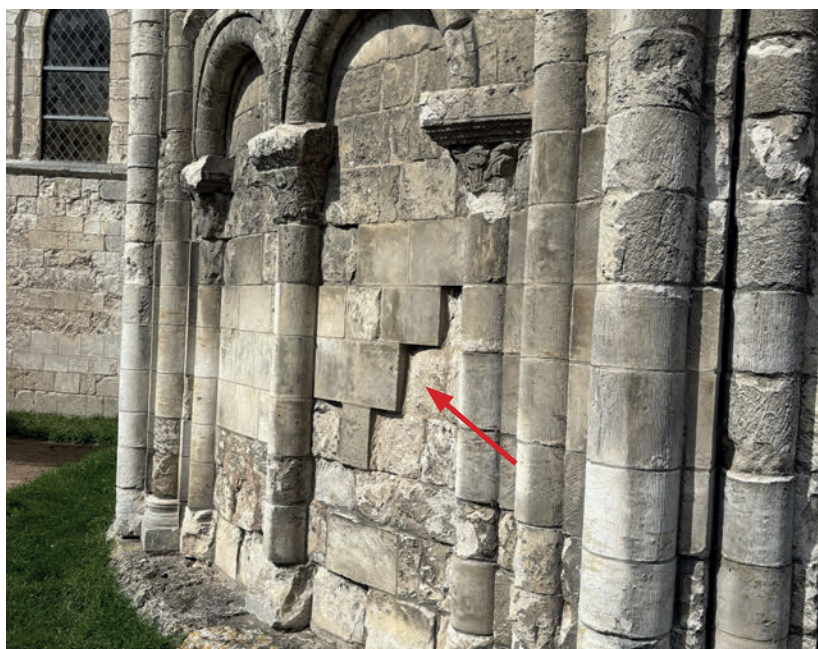
13. Forte érosion des surfaces inférieures, notamment les bases des colonnettes, présence d'un appareillage peu intégré probablement dus à la reprise d'un comblement ultérieur.
