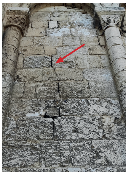
14. Fissure au droit des arcades aveugles.
