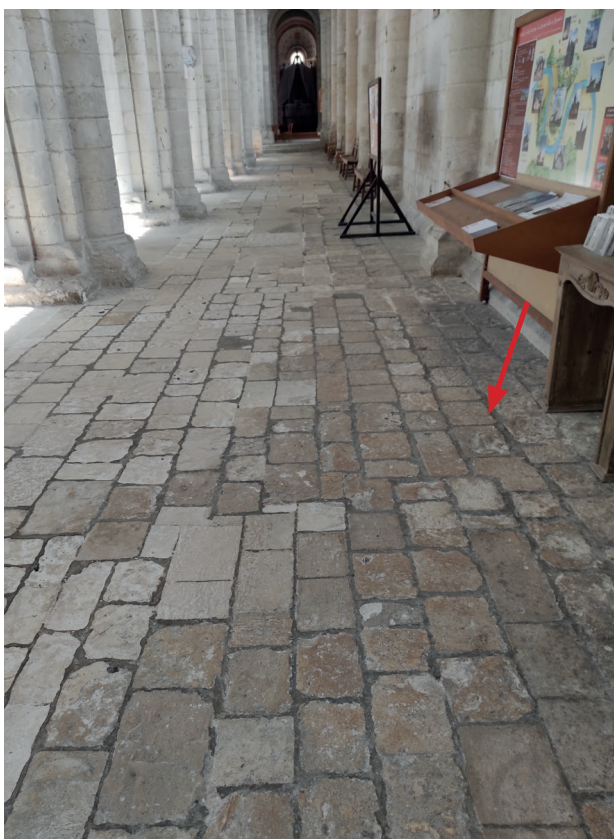
54. Pavage présentant des joints fortement hydrauliques, auréoles d'humidité au droit du sol.
