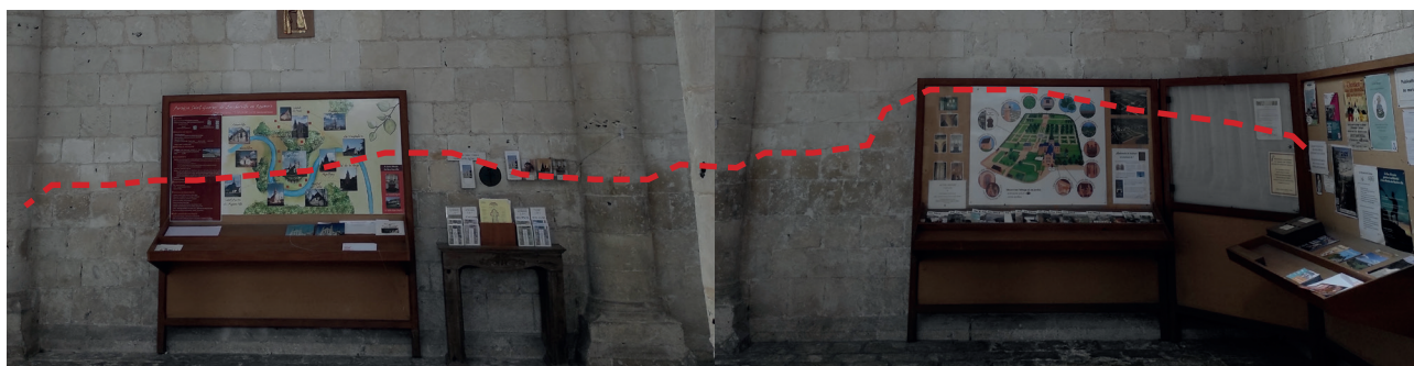
31. Traces de remontées capillaires, auréoles et dépôts salins : illustration des défauts d'hygiène sanitaire en pied.
