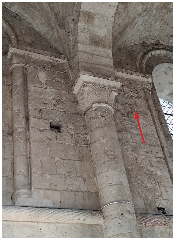
50. Érosion importante des pierres de parements.
