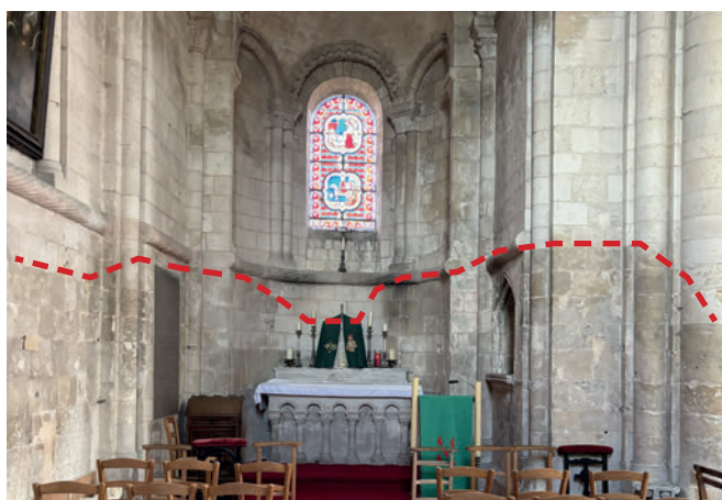
46. Remontées capillaires marquées par un dépôt salin.
