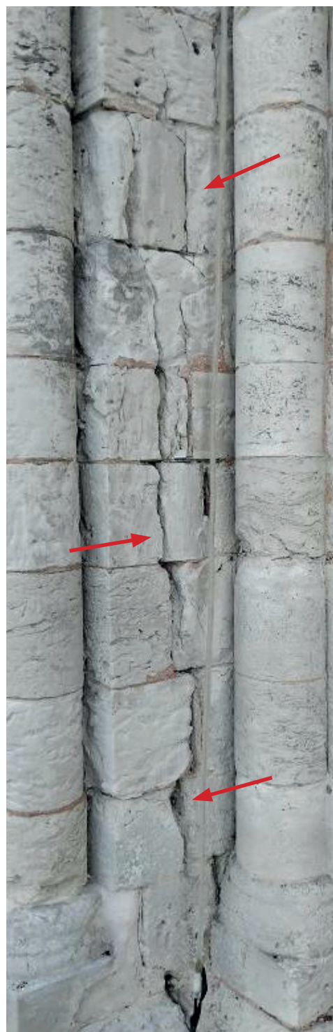
6. Fissuration «coup de sabre» illustrant le déliaisonnement sur le retour de la tourelle Nord-ouest, profil de fissure assimilé en éclatement interne de la pierre.
