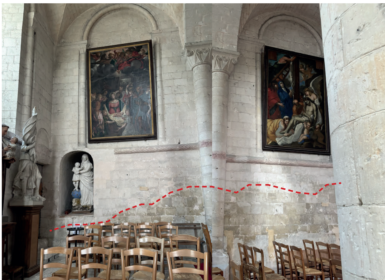
45. Remontées capillaires marquées par un dépôt salin.
