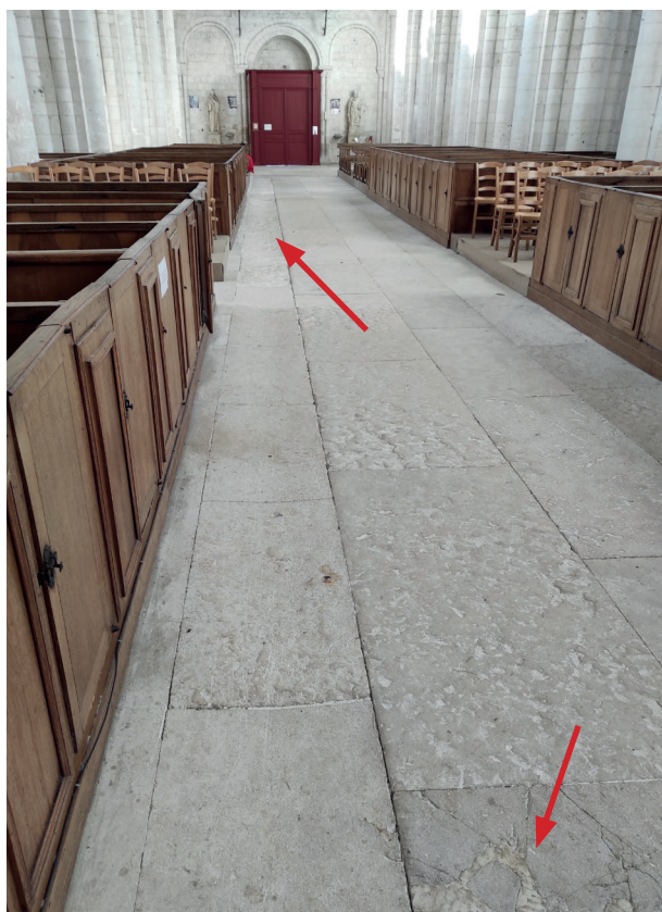
56. Dalle du sol cassée et signes d'usure localisés.
