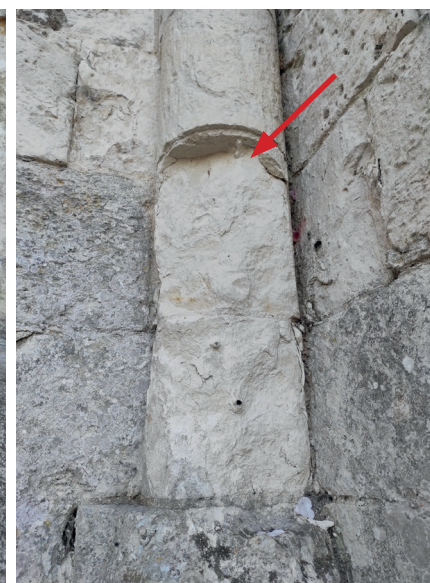
16. Colonnnette présentant une érosion importante de matière au droit d'un tambour.
