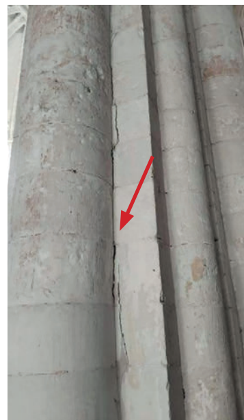
53. Fissuration verticale au droit des colonnes engagées.
