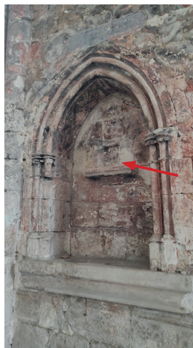
35. Effacement des motifs et perte de matière au droit d'une niche.
