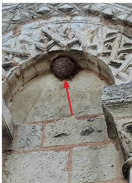
10. Colonisation de l'édifice par les volatiles: implantation de nids à l'abri, en intrados d'arcades des chapiteaux: vieillissement et dégradations.
