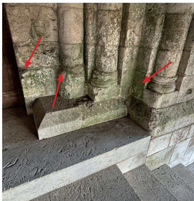
7. Développement de mousse et de micro-végétaux dû à une forte présence d'humidité par capillarité, perte de la finesse des décors en pied de colonnette et perte de matière.
