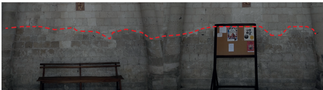
32. Traces de remontées capillaires, auréoles et dépôts salins.
