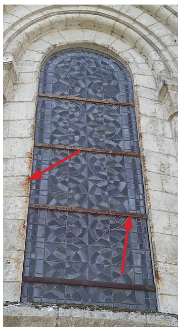
7. Barlotières corrodées se repercutant sur la pierre, vitrail encrassé.
