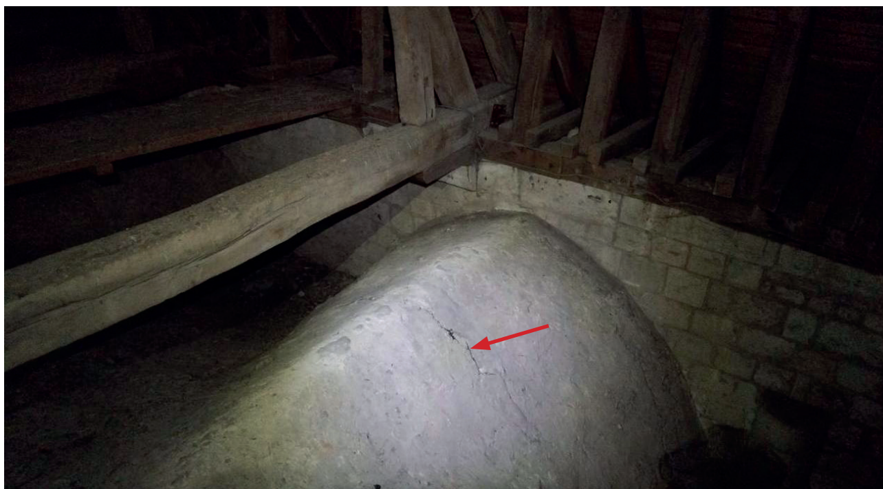
9. Fissure traversante en extrados de voûte (vaisseau principal de la nef).
