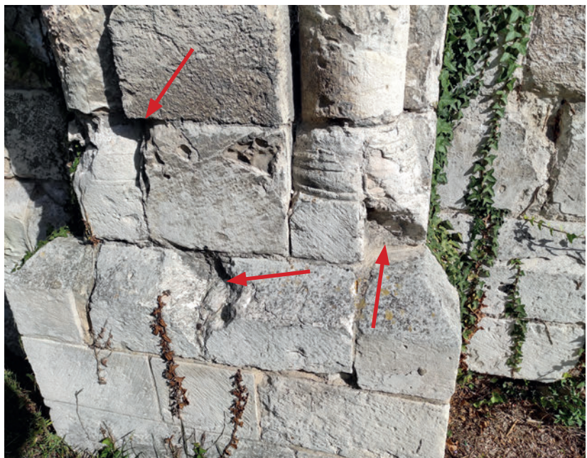
5. Pied de contrefort fortement altéré, érosion importante et nombreuses pertes de matière constatées. Grande perte de détails des modénatures.
