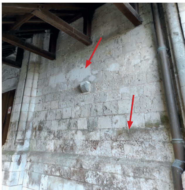
6. Auréole d'humidité en partie basse, encrassement généralisé et érosion de la pierre, trace d'enduit de rebouchement grossier.
