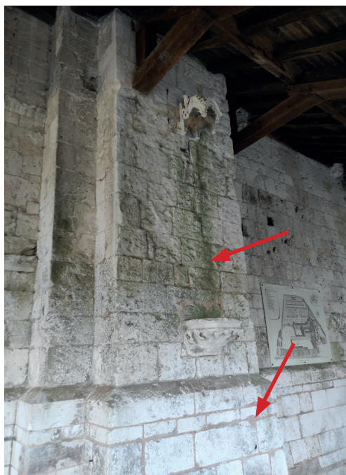
8. Développement de mousse et de micro-végétaux, érosion de la pierre en partie haute et différence de traitement marquée entre le soubassement et les parties supérieures.
