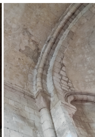
48. Décollement et chute des enduits.
