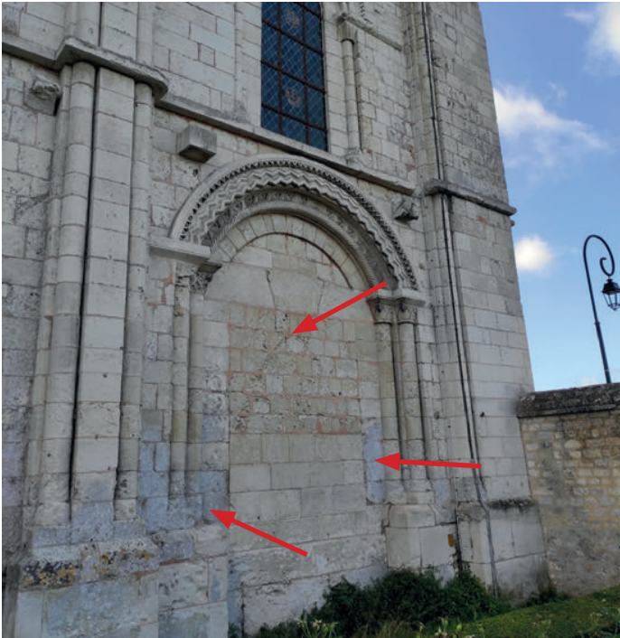
1. Développements de mousse anciennement traitée, pieds de colonnette aux motifs sculptés effacés, rejointoiements grossiers.
