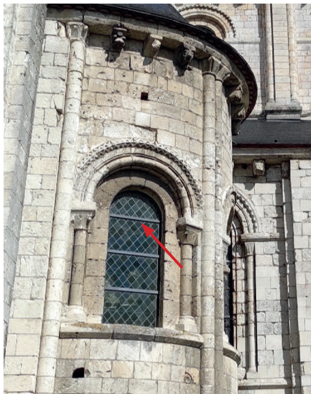
19. Encrassement plus marqué au droit des baies.
