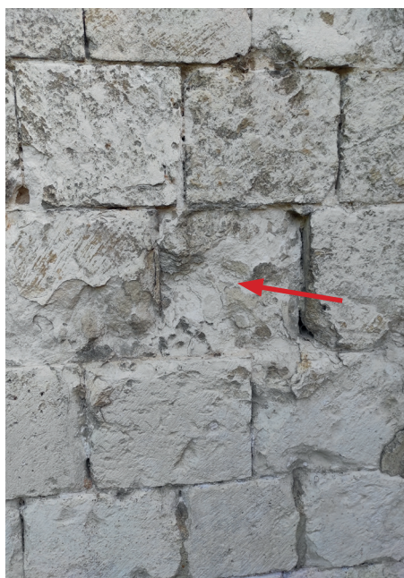
6. Érosion et desquamation des pierres.
