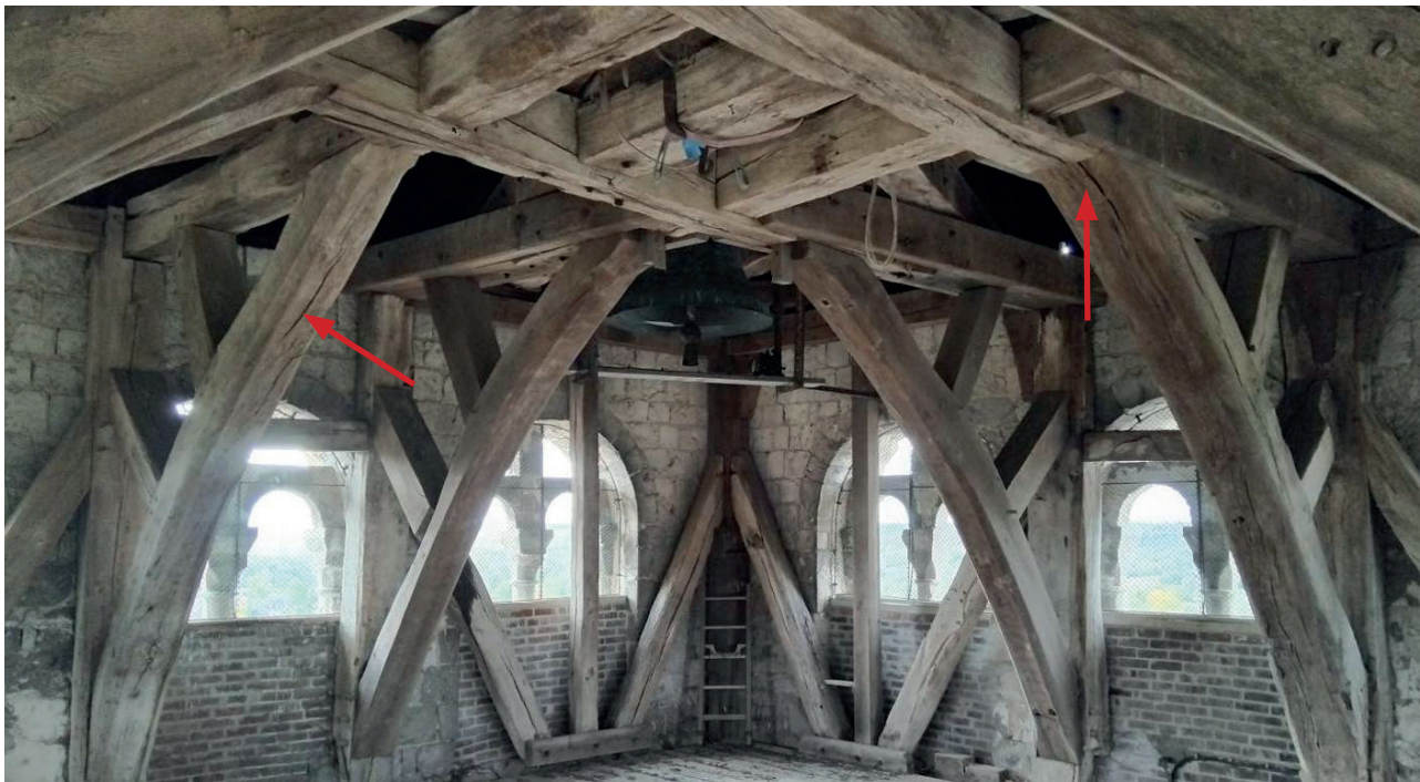
1. État sanitaire de l'enrayure correct, jambages présentant des gerces importantes. (Beffroi)
