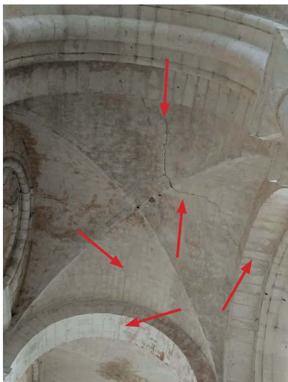
14. Fissuration oblique du voûtain, fissuration longitudinale des voûtes.
