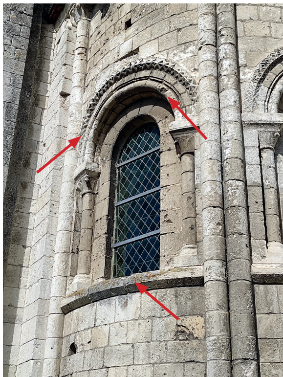
18. Encrassement du bandeau et perte de matière au droit des archivoltes encadrant la baie.
