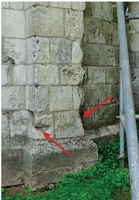
1. Absidiole Nord, forte érosion des contreforts et perte importante de matière.
