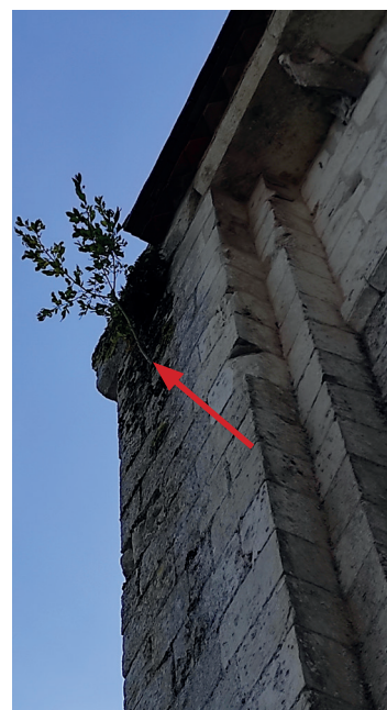
6. Développement d'un arbuste au droit de l'élévation par défaut d'entretien.
