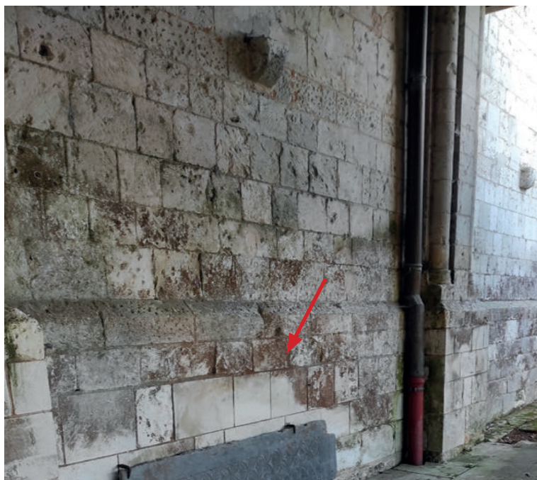
9. Grande différence d'altération des pierres, présence supposée de pierres de remplacement; important défaut d'hygiène sanitaire.
