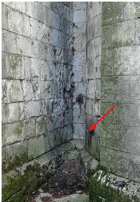
2. Présence accrue d'humidité et d'encrassement entre le bas-côté et l'absidiole Nord.
