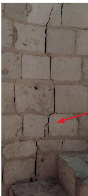
21. Fissuration «coup de sabre» de la maçonnerie de la tourelle d'escalier.
