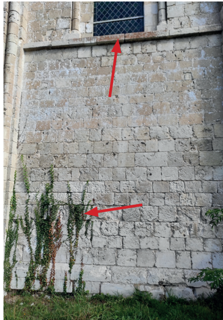
2. Érosion des parties inférieures et développement de plantes envahissantes. Bandeau présentant des détériorations liées à l'humidité.
