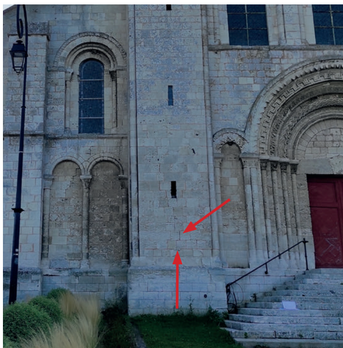
5. Fissuration verticale traduisant des tensions subies à une époque par l'ouvrage construit. Cependant, témoin verre non fissuré.
