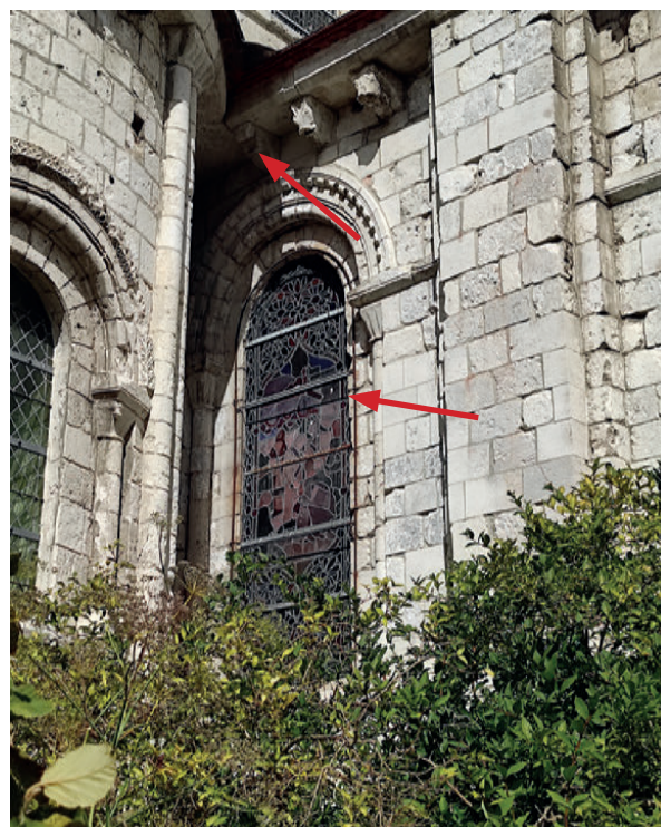
15. Perte de qualité des modillons et corrosion d'armatures (ancien grillages ?) autour des baies.
