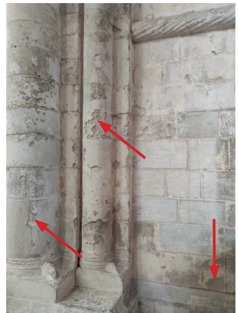
44. Pierres érodées, rebouchage et joints grossiers, traitant les conséquences sans régler les causes.
