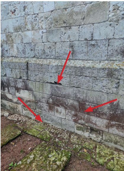
3. Présence accrue d'humidité en pied d'élévation, développements de mousses et de micro-végétaux, érosion des pierres et perte de matière.
