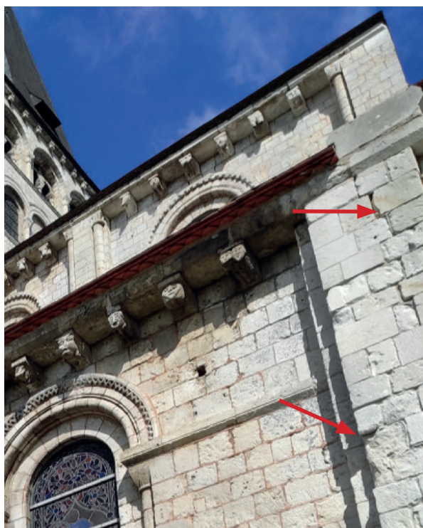
14. Déjointoiement des maçonneries, desquamation des pierres.
