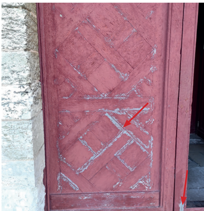
13. Bois de la porte principale de l'édifice: perte de la peinture de protection, bois exposés voire affamés.
