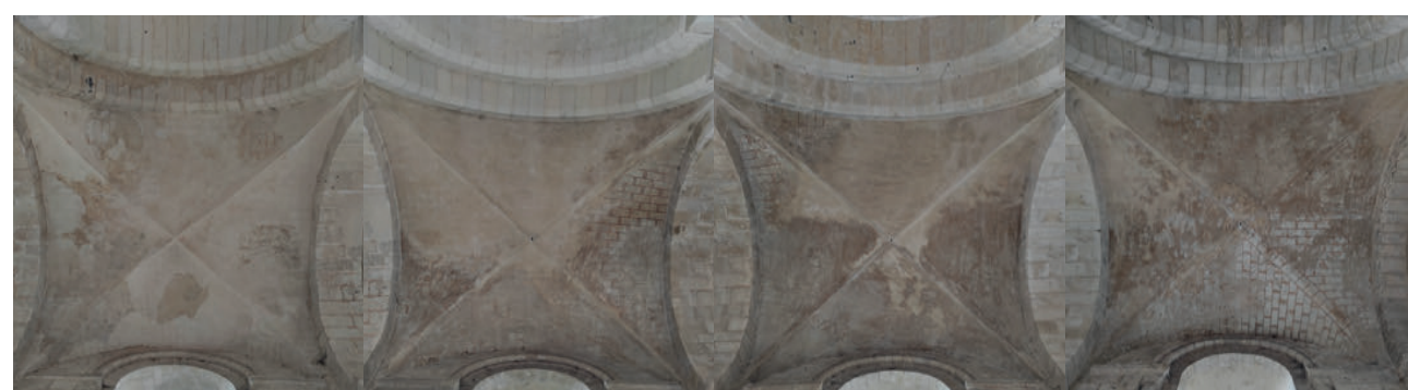
13. Voûtes des bas-côtés de la nef, traces de décors peints fortement altérés, traces d'anciennes infiltrations d'eau, visuel hétérogène.
