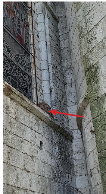
3. Nid d'oiseau placé sur les allèges de baies.
