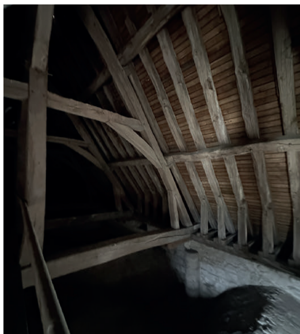
8. Développement cryptogamique au droit de la panne intermédiaire et fléchissement alimenté par une infiltration localisée ? (vaisseau principal de la nef).
