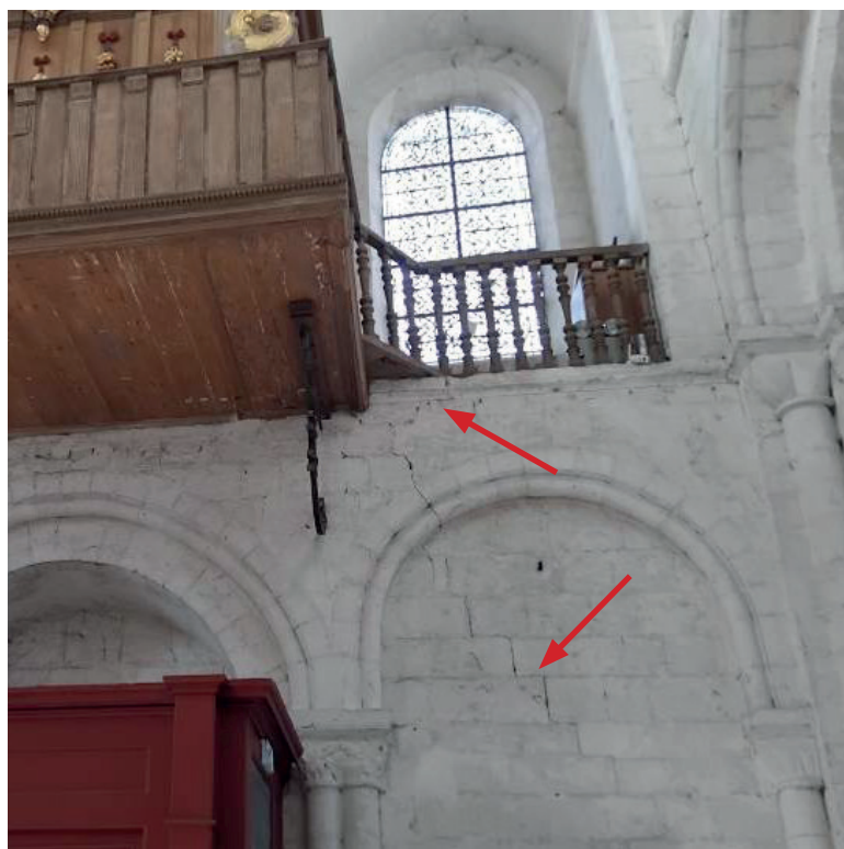
19. Fissuration en escalier au droit de l'appui de la tribune d'orgue.
