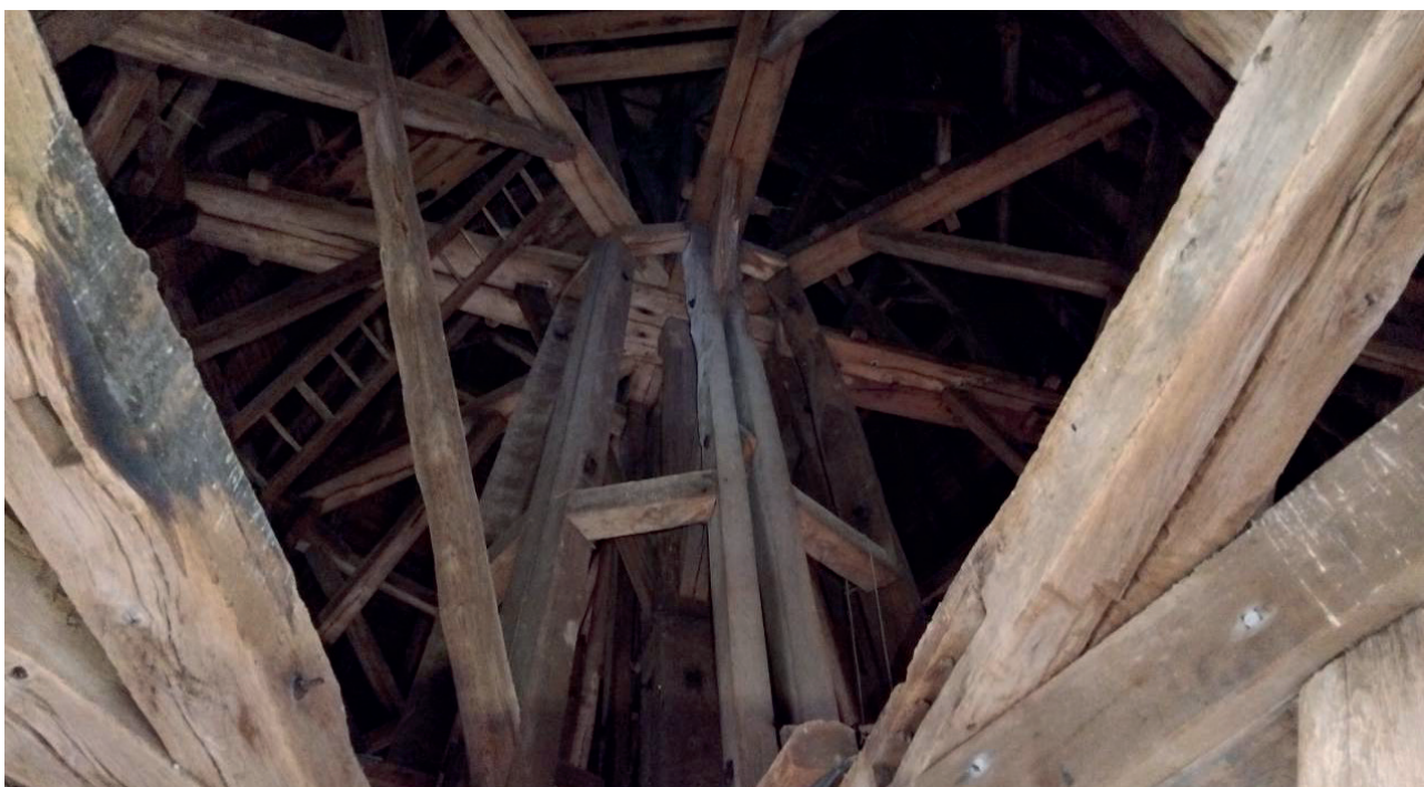
2. Présence de gerces et de bois de réemploi sur les enrayures (beffroi).
