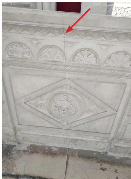
52. Table de communion fissurée de manière traversante (armatures internes?).
