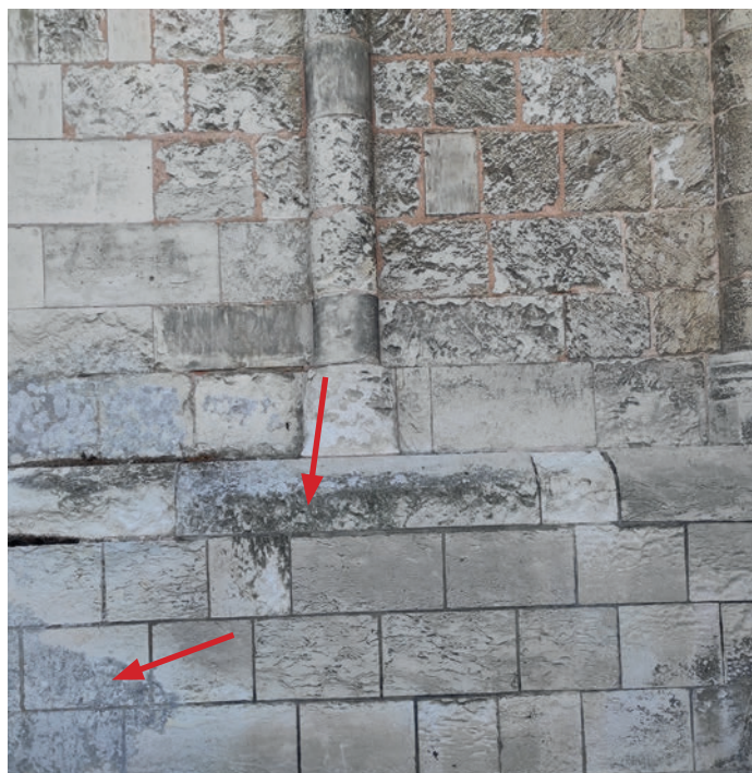
8. Les maçonneries présentent de nombreuses altérations: érosion, développements de mousse anciennement traitées et encrassements. Perte des détails de sculptures qui ornent les pieds de colonnette.
