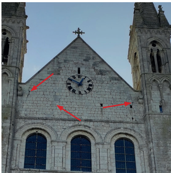
4. Réseau de fissures biaises sur le pignon traduisant des mouvements entre les deux tourelles, avec lessivage de maçonnerie.
