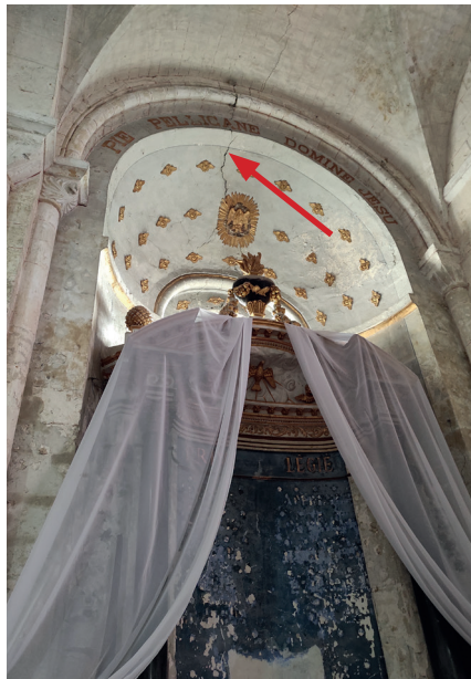
40. Fissure au droit de la voûte en cul-de-four.
