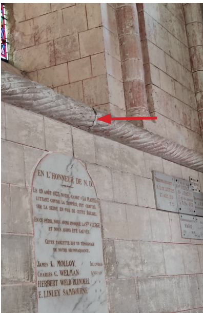
42. Fissure des parements et du bandeau.
