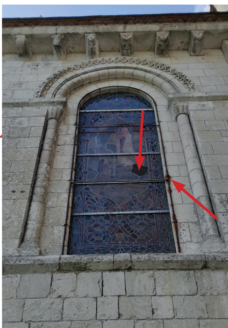
4. Bas-côté Nord du chœur, chute d'un élément de verre du vitrail. Corrosion de l'armature se répercutant sur la pierre; absence de protection grillagée.
