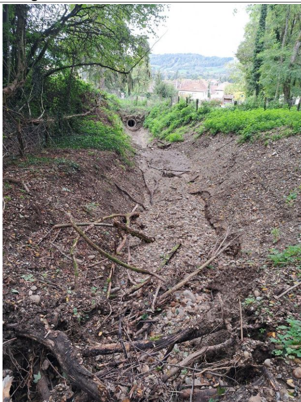
▲Buse de passage sous le VC n°1 et le bassin d'orage à l'amont formé par des seuils en bois. On note la nature gravelo-limoneuse du lit du cours d'eau, facilement érodable.
