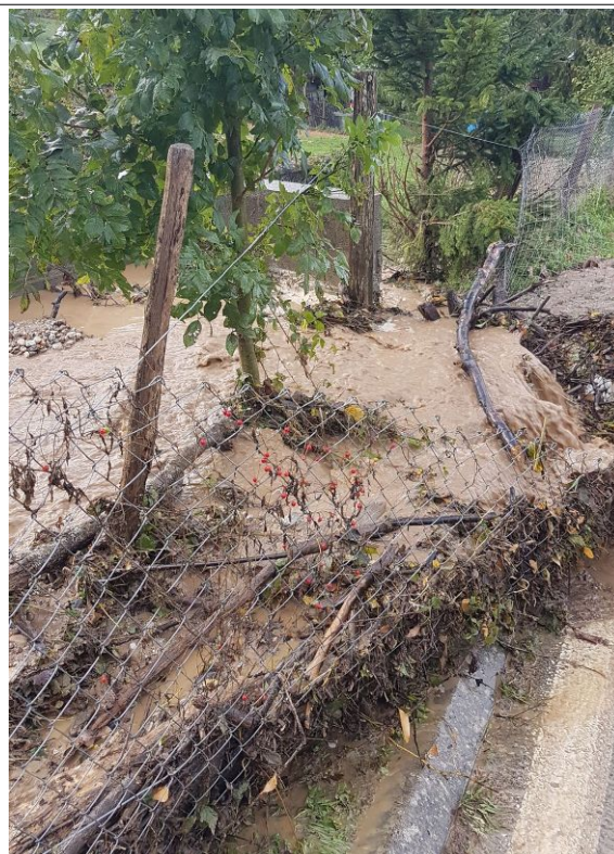
▲Avaloir le long du VC n°1 colmaté par le transport solide du ruisseau, crue du 22 d'octobre 2022 (photo témoin).
