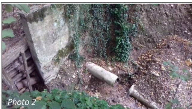
▲ Vue aval de l'ouvrage amont en novembre 2019 (RTM, 2019). L'exutoire du bassin est fermé par un ensemble de traverses en bois de grosse section. La buse de fond ne présente plus d'écoulement, et est déchaussée dans le franchissement du lit aval. La surface approximative de l'ouvrage est de 230 m².
