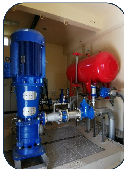
Station des captages de Dracy
