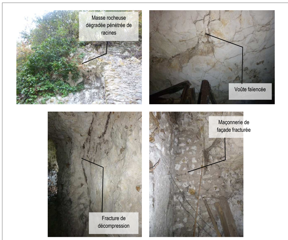
Figure 16 : exemples de désordres au niveau du secteur 6
