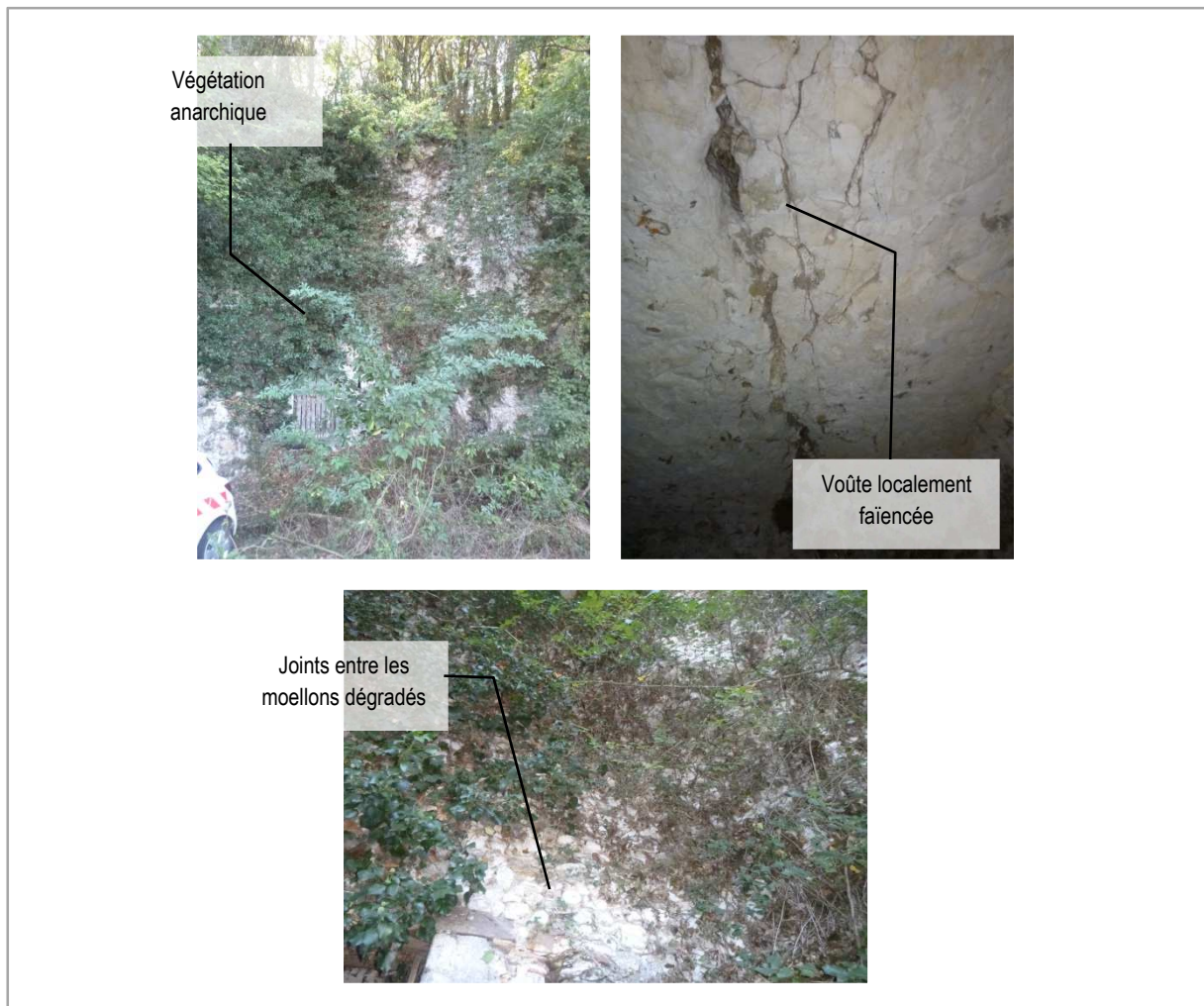
Figure 18 : végétation anarchique et blocs instable au niveau du secteur 7
