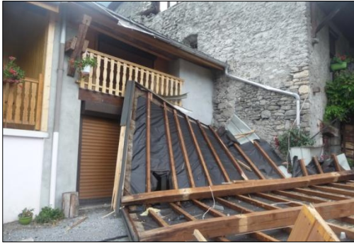
Une toiture arrachée et envolée
