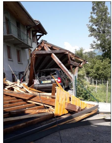
De nombreux dégâts importants ont été constatés le lendemain de la tempête
