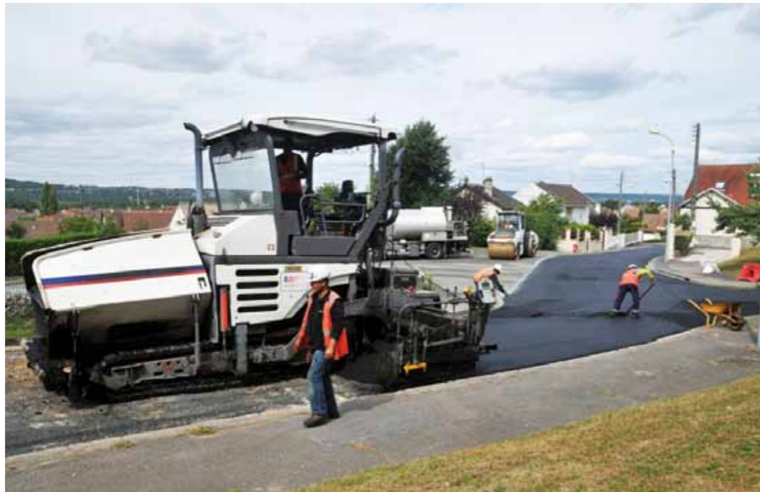
Depuis 2017, la création, l'aménagement et l'entretien de la voirie sont entièrement gérés par la communauté urbaine. De même que l'entretien des trottoirs, la signalisation et les parcs et aires de stationnement.
