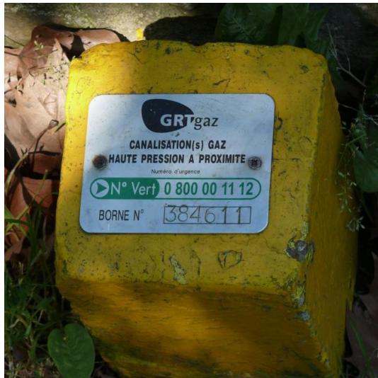
FIGURE 36 : BORNE DE SIGNALISATION D'UNE CANALISATION SOUTERRAINE DE GAZ HAUTE PRESSION A PROXIMITE DU PARC DE MONTMIRAULT (photo TRANS-FAIRE)
