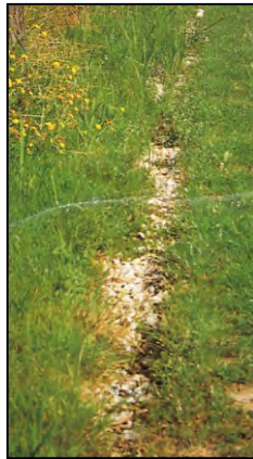
Fossé plat de traitement des eaux de pluie.
