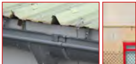
Etat des salles Mermoz avant travaux
