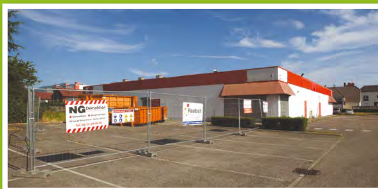
Démarrage du chantier - transformation de l'ancien ED en maison de la solidarité - Cf WVI N°10
