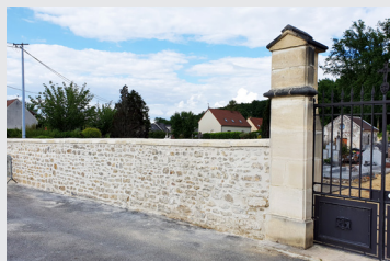
Réfection du mur d'enceinte de la rue du Cimetière fortement dégradé par les infiltrations.
