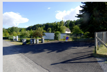
1er trimestre 2020 : Travaux de voirie aire de retour- nement du camion du Sirtom sur le Vieux chemin de Reims.
