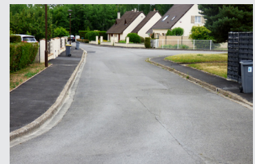
Lotissement du Bois Brûlé : réfection des trottoirs après la mise aux normes de l'éclairage public.
