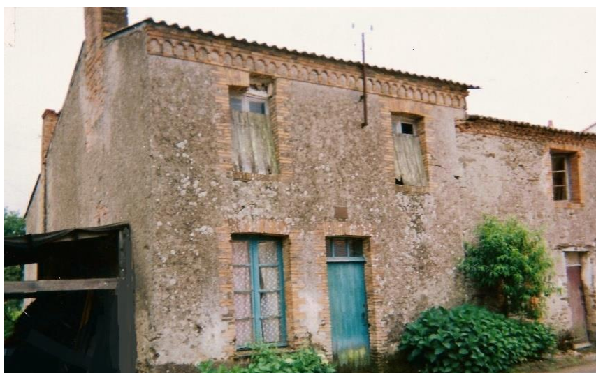
Une maison du Moulin Cassé avant rénovation. On y remarque un bel ornement de briques chantignolles aux ouvertures avec un complément d'arquets sur la corniche
