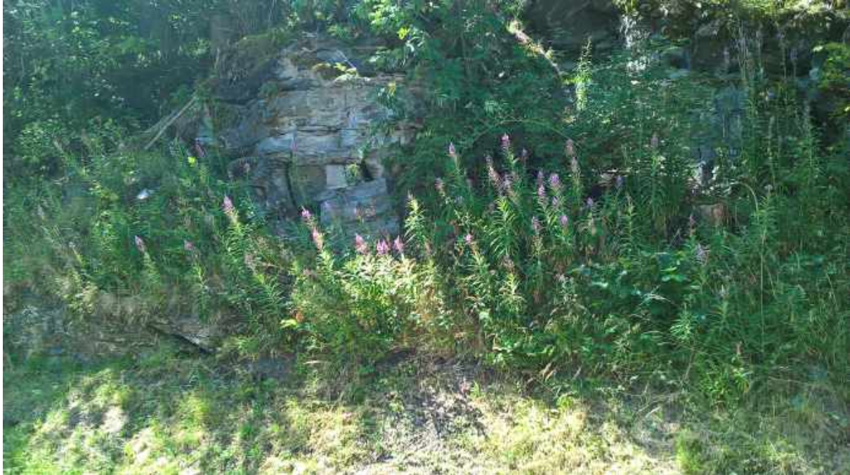
Photo 1 : bloc disloqué en bordure de RD84b qui paraît ne pas avoir été charrié.
