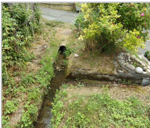
Figure 3.10: franchissement de la montée des Guiguetières par le chenal du ruisseau du Biel. On notera le faible diamètre de la buse.
