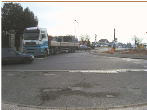
Un carrefour qui pose problème
