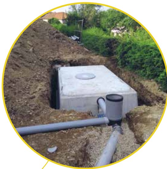
Partie nord : cuve de 15 m 3 à débit réservé
