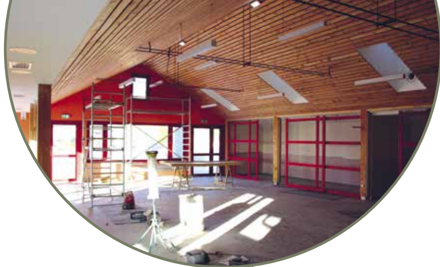
Les luminaires et les grilles de ventilation
