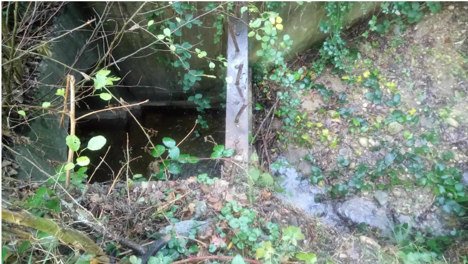
Annexe 3 : Photo du dégrilleur du champ de tir
