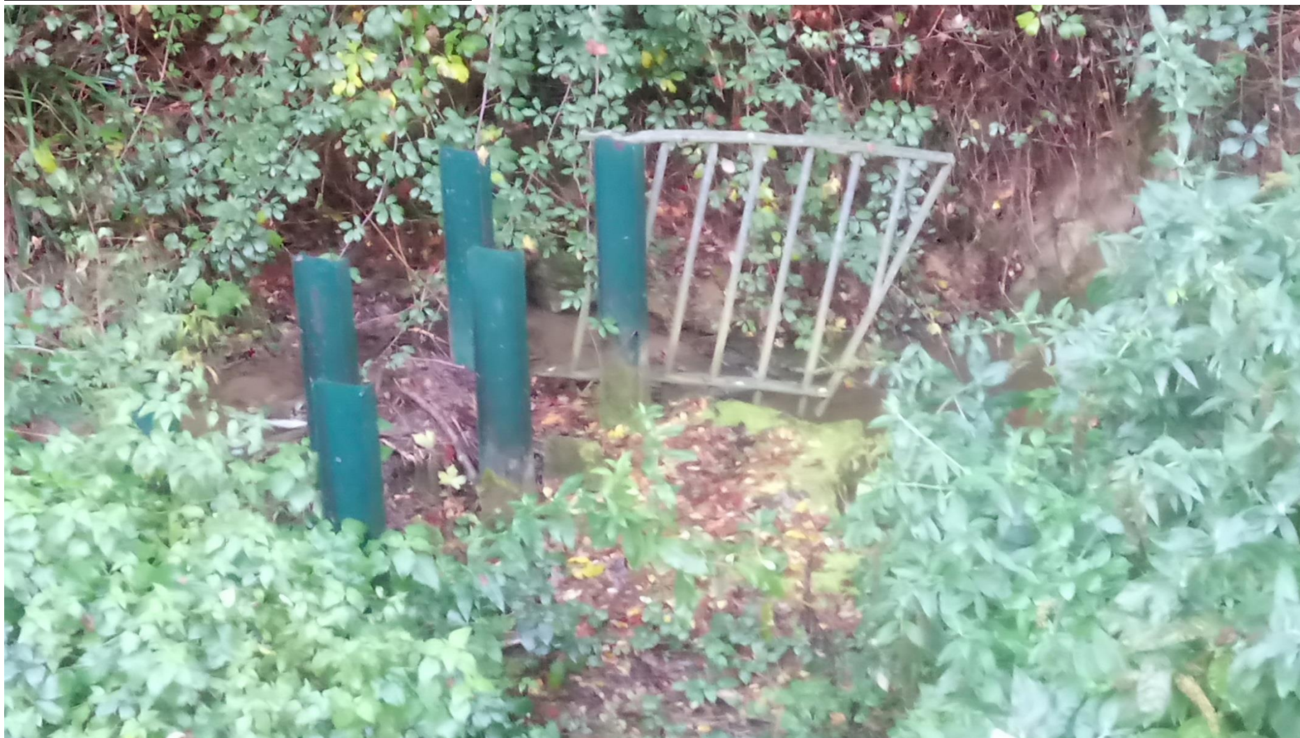
Annexe 4 : Dégrilleur en amont du champ de tir.
