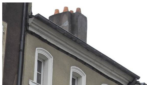
Corniche en pierre badigeonnée
