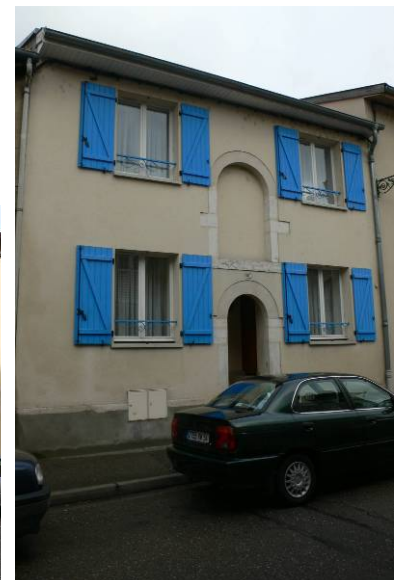
Transformation des baies et enduit saillant ayant altéré le bâtiment
