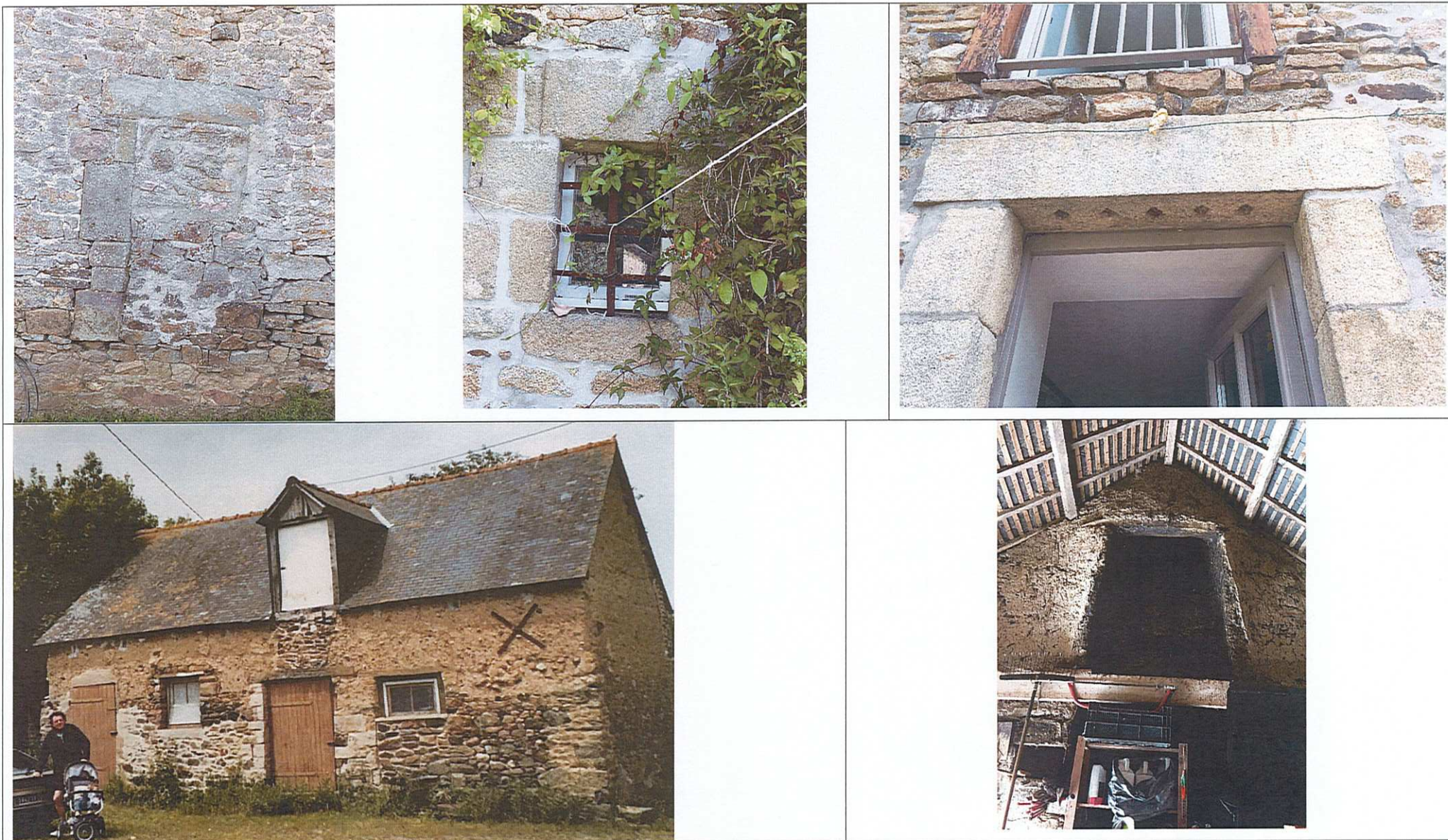
Fig.56, détails architecturaux, 1 : porte bouchée sur la façade nord du logis, 2 : petite fenêtre à barreaux sur la façade sud du logis, 3 : reprise d'un linteau ancien, 4 : maison en bauge, détail de la cheminée sur le pignon sud.
