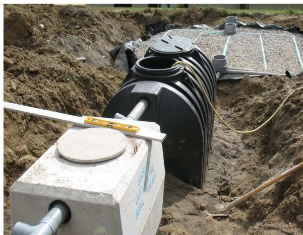
Assainissement non collectif composé d'un bac dégraisseur, d'une fosse toutes eaux et d'un filtre à sable drainé
