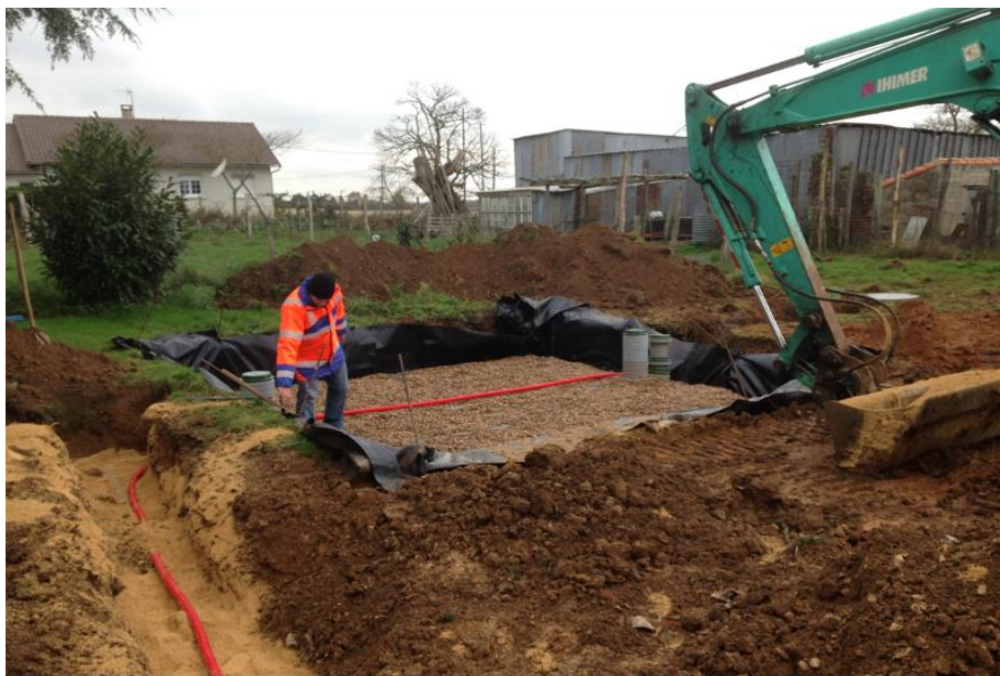
Assainissement non collectif
