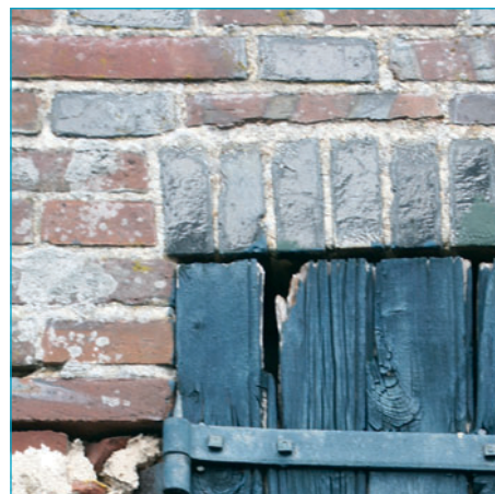
Maillebois : Briques de teinte bleue, flammées.
