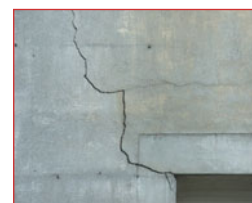
Enduit ciment sur une maçonnerie ancienne : fissurations
