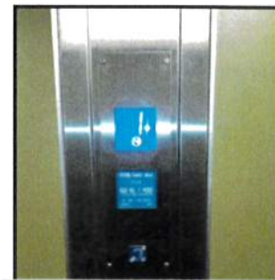
Ascenseur Indication visuel et sonore
