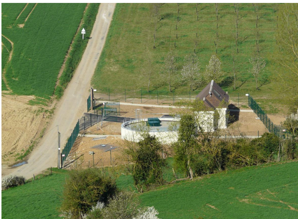
Le 'surpresseur' (= deux pompes hydrauliques) dorénavant en fonction pour notre alimentation en eau.
