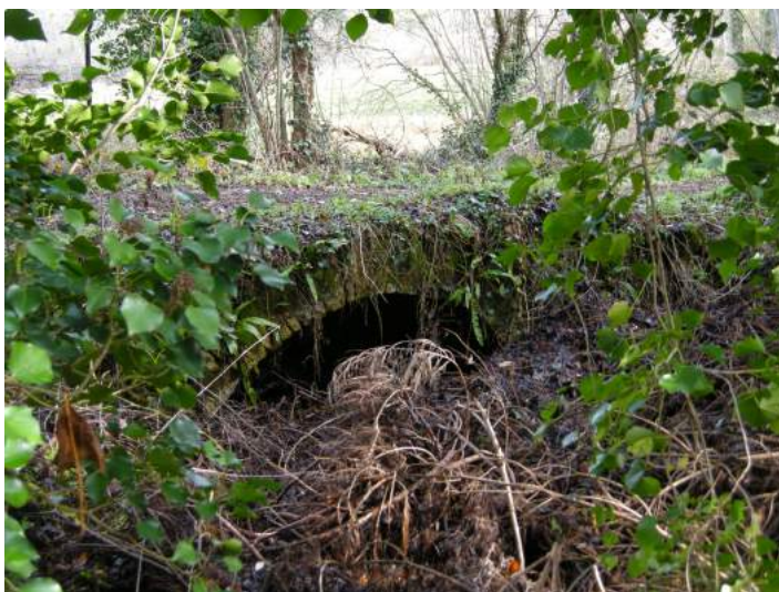
Le ponceau de Chambon enjambe le bief. Des déchets végétaux ont été versés de chaque côté. Cliché Henri DONZAUD, 13 janvier 2017.
