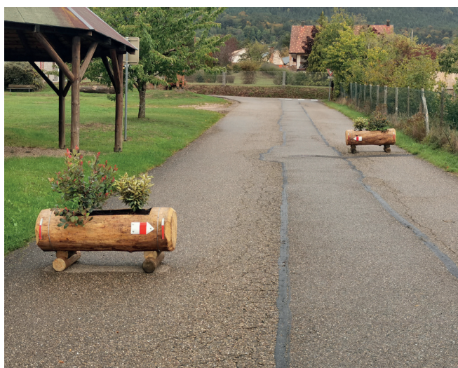
Pose de bacs à fleurs pour ralentir les véhicules dans la descente de la salle des fêtes
