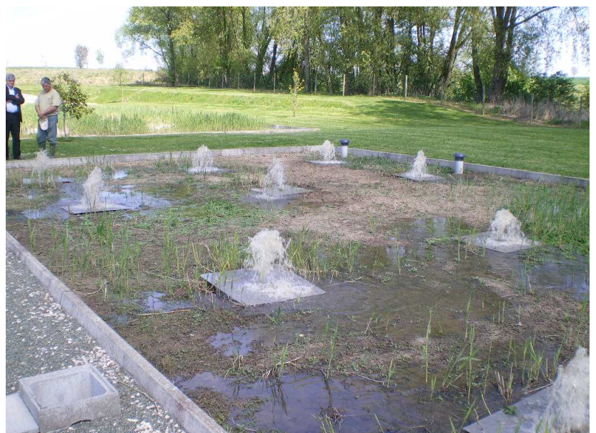
Les eaux usées sont versées dans les lits filtrants plantés de roseaux pour épuration
