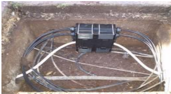
Point de branchement en chambre
