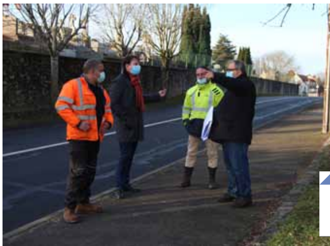
Pour rejoindre l'autre extrémité du chantier, les câbles en provenance du Poste Guhermont seront enfouis sous les rues Camescasse, des Sorbiers et de Nuisement. Les agents de la ville, d'Enedis et l'entreprise sous traitante se sont rendus sur place.
