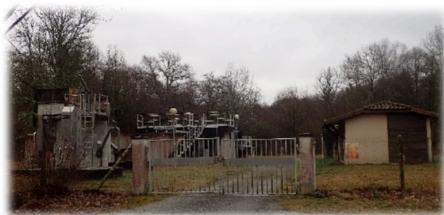
Photo 52 : Station d'Épuration de Saint-Pardoux
