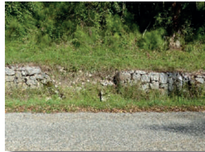
Linéaire de gabions effondrés dans le périmètre
