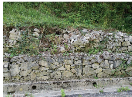
Gabions à maille torsadée sous le hameau de Serre Longue
