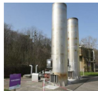
Info Grand Paris Sud Centrale Biogaz
