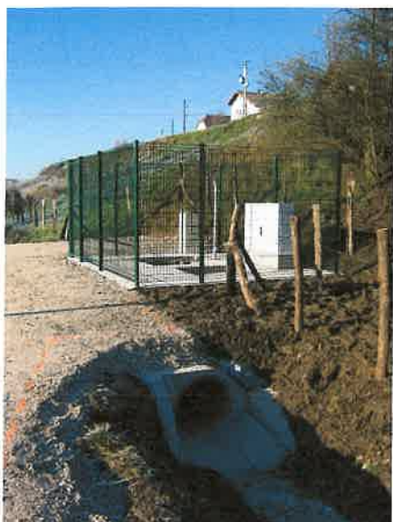
La pompe de refoulement
