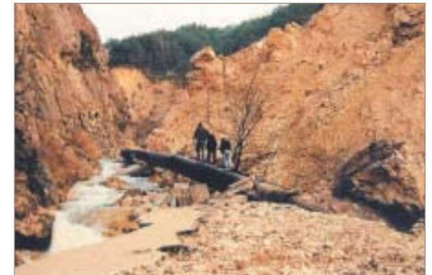
Boulc, la route des Roches (RD148) après le glissement du 11 janvier 1994
