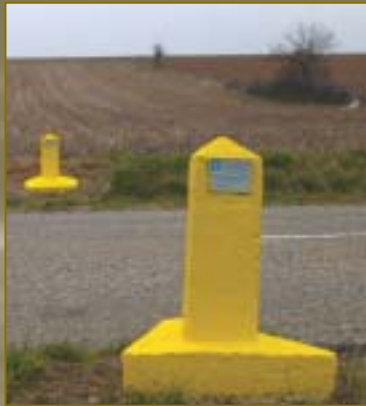
Borne de signalisation des canalisations de Gaz de France
