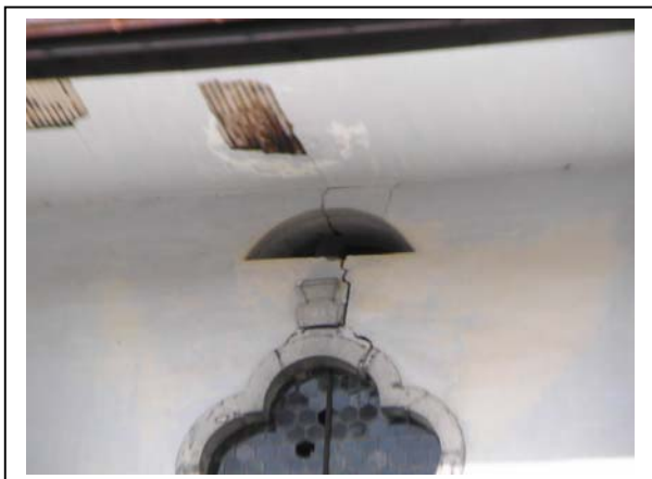
Nombreuses fissures sur les murs de l'Eglise. Source : MB Management, novembre 2009
