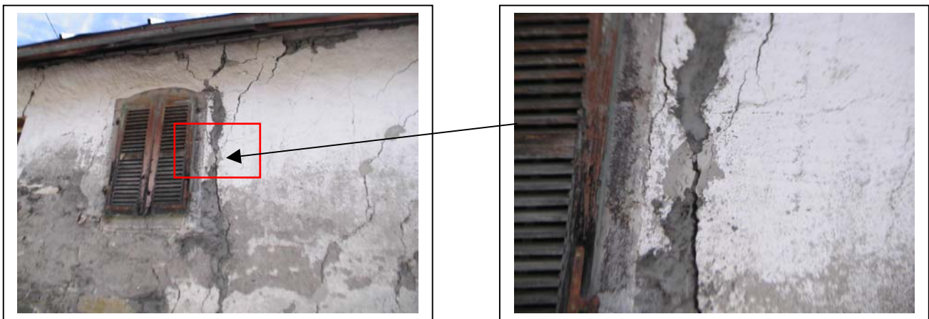
Fissures sur les murs d'une maison au hameau de Chaucisse – Les Témoins mis en place en avril 1983 atteste que le glissement est toujours actif. Source : MB Management , novembre 2009
