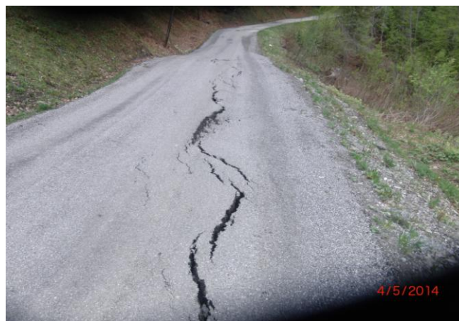
Figure 14 : Route de Chaucisse fendue et déplacée
