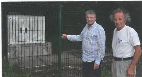
Claude Zucchetti présentant à Georges Ruelle les nouvelles clôtures de protection des pompes de relevage.
