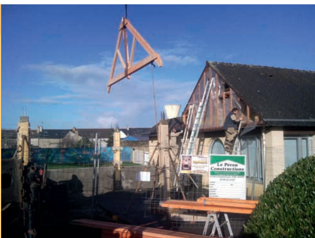
Un moment inédit : la pose de la charpente du préau de l'école maternelle.
