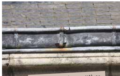
Vue sur l'état des gouttières
