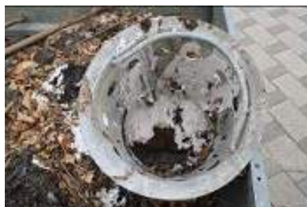
Fleury : panier d'un avaloir souillé par de la peinture
