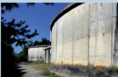
Réservoirs de Château Corbeau
