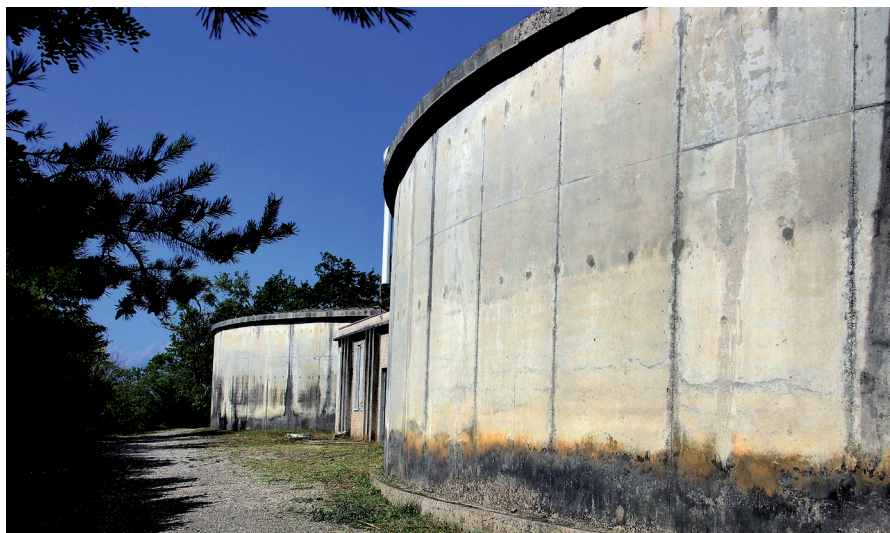
Réservoirs de Château Corbeau
