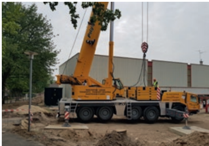
Installation du NRO
